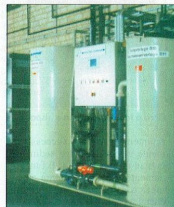
TRATTAMENTO FISICO-BIOLOGICO DEGRASSATORI - FLOTTATORI
